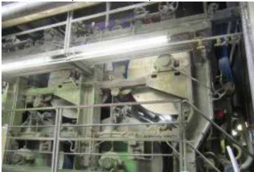
Охлаждающие приводы вентиляторов и теплообменников
