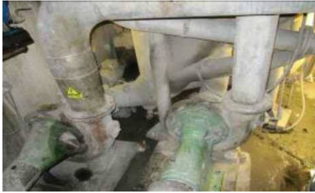
Насос напорного бака и насос первой ступени
